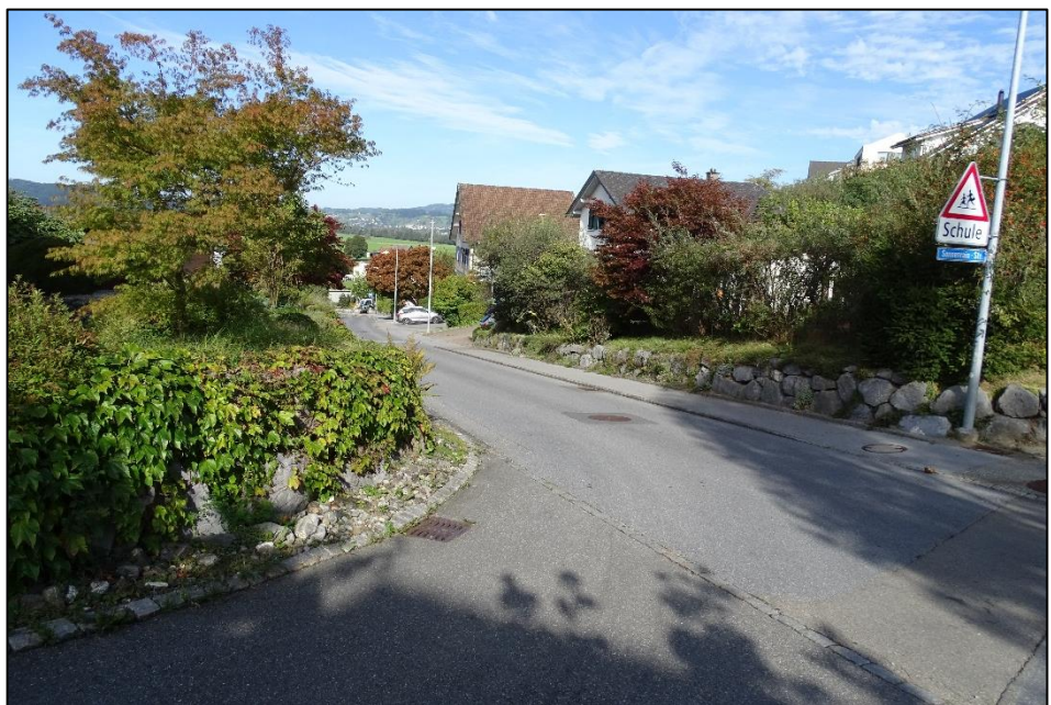
Abb. 16: Foto Problematische Mauer am Knoten Blattenstrasse/Sonnenrainstrasse, Quelle: R+K
